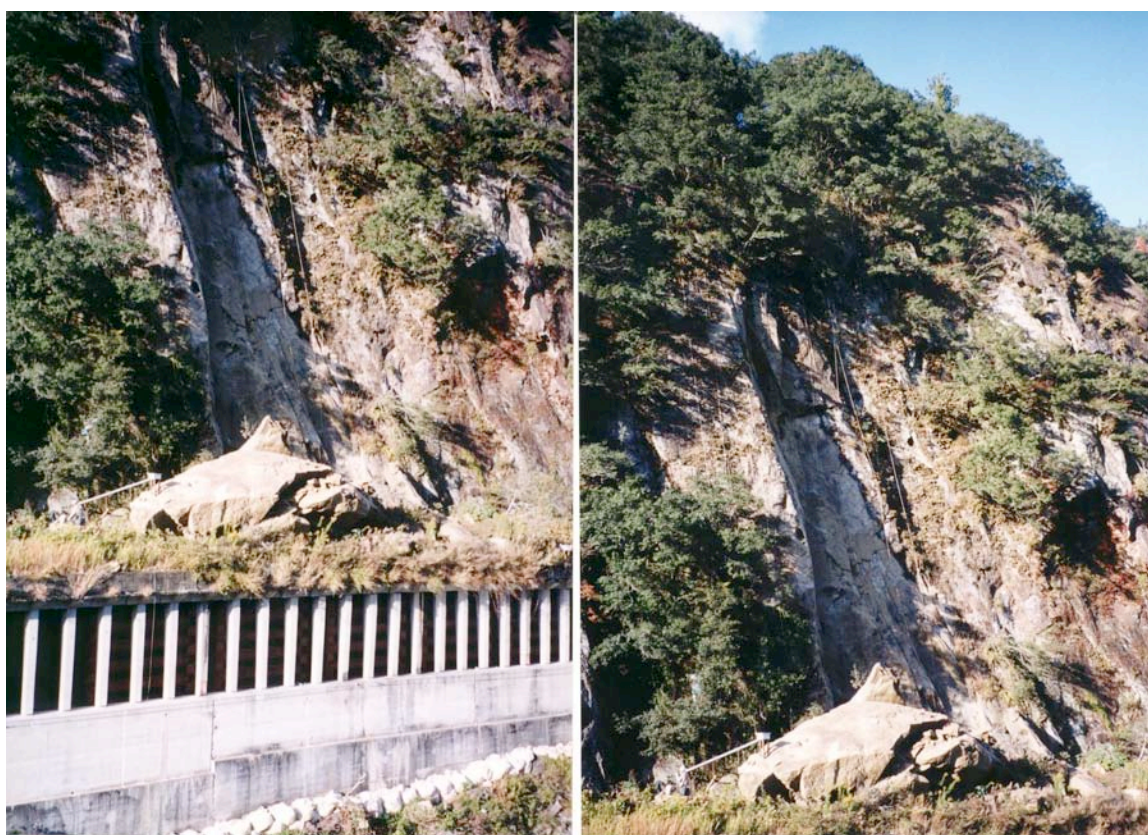
図 15 ロックシェッドを直撃した岩塊（古座川町立合，2002年11月撮影）。左：ロックシェッド部分，右：上方の急崖部分。
