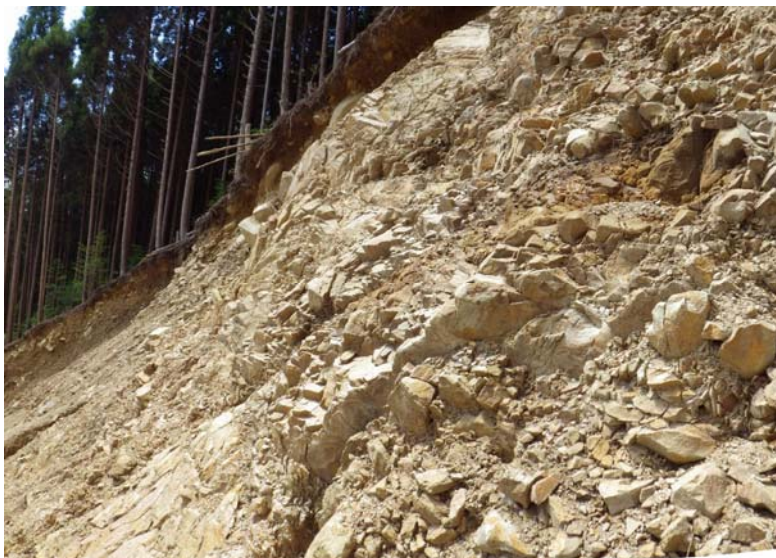
図-2.35 崩壊地に露岩する砂岩層
