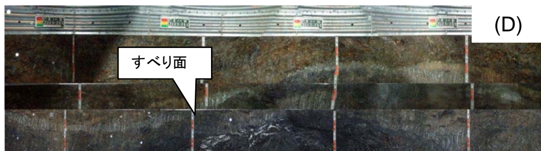
(A) No. 3 集水井工 (B) No. 5 集水井工 (C) No. 7 集水井工 (D) No. 8 集水井工
