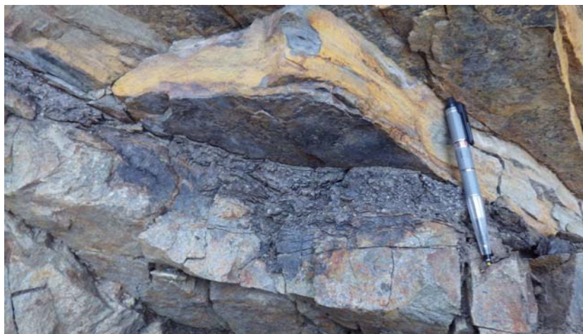
図-2.36 崩壊地末端部に露岩する破碎状泥岩
