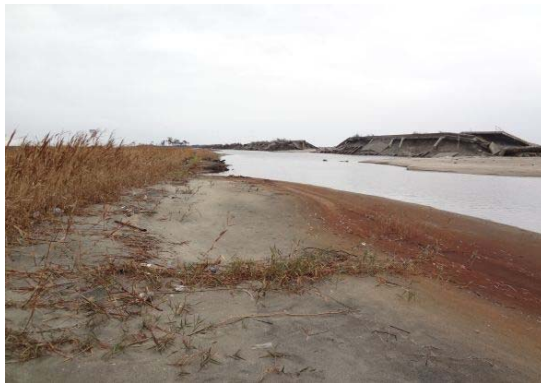
写真 2.7 大洲海岸の破堤の様子
