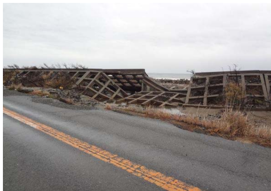
写真 2.8 大洲海岸の堤防被災状況
