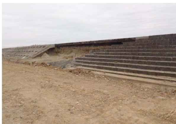
写真 2.6 野蒜海岸(堤防陸側より撮影)
