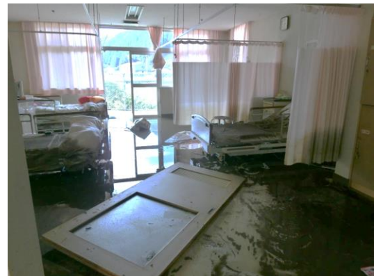
写真-4 被害を受けた翌日の特養S荘の居室 (徳島県南部総合県民局より提供)
