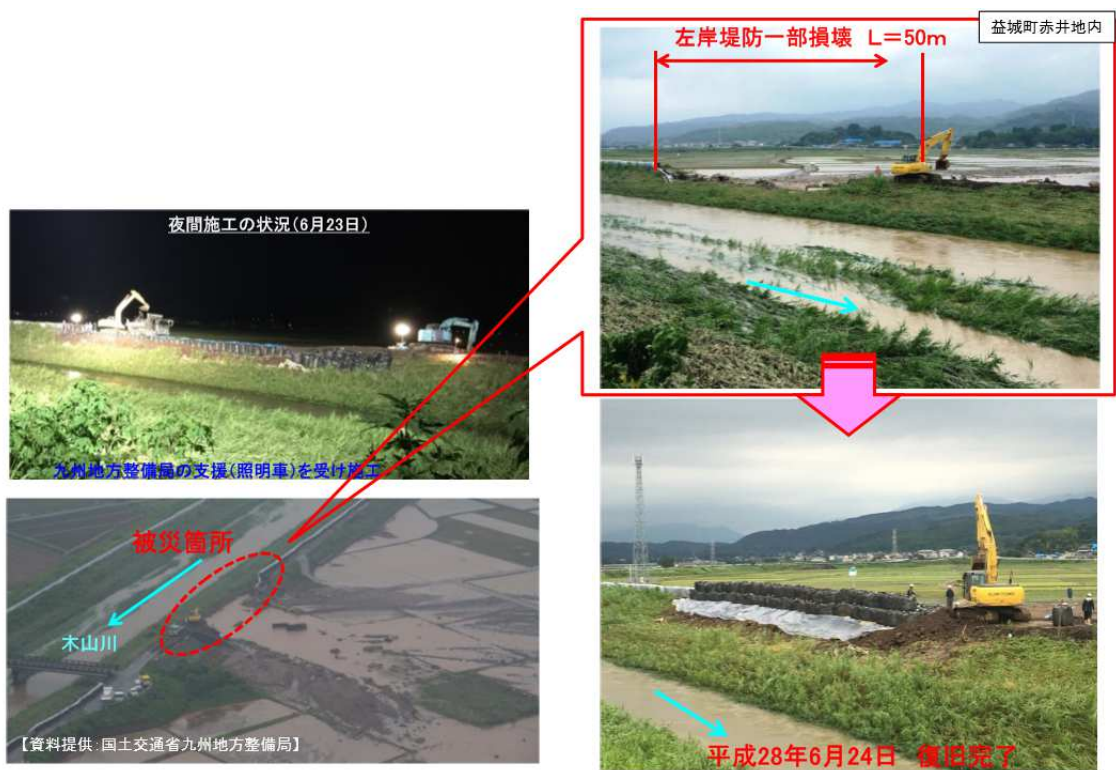
写真 1.4 熊本豪雨により損壊した木山川左岸の堤防とその復旧状況 4)
