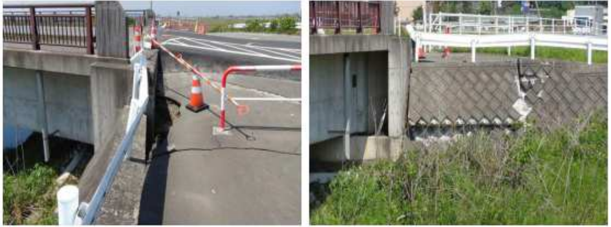
写真 1.2 熊本地震による新木山橋の被害 3)
