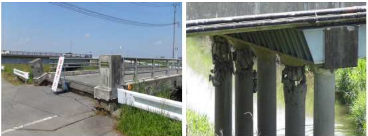
写真 1.3 熊本地震による第一畑中橋の被害 2)
