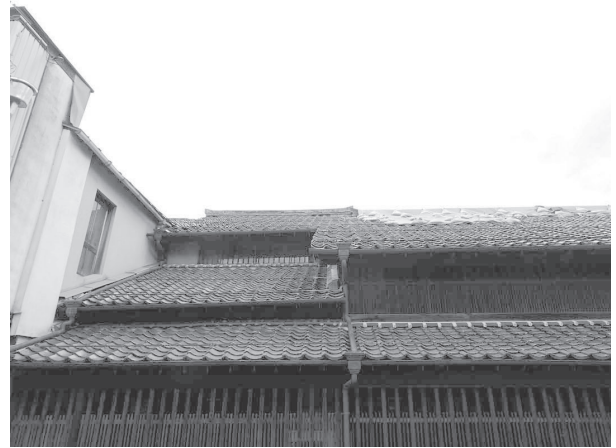
写真-1 被害の様子
