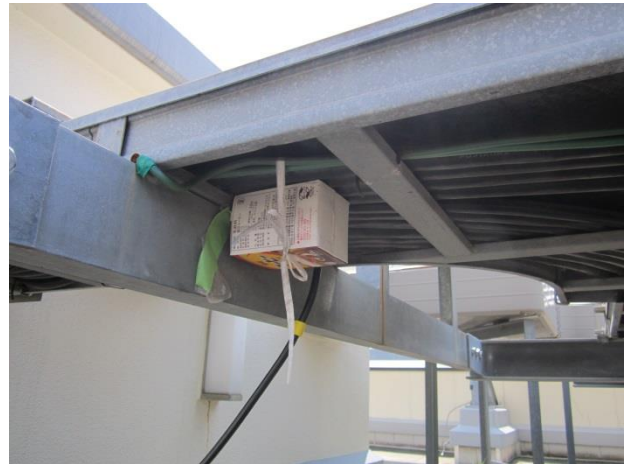
図2 EX300D設置状況
