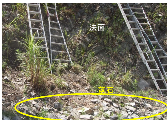
写真 5.10 現地砂岩落石状況
