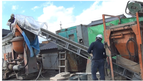
湿式吹付けプラント
