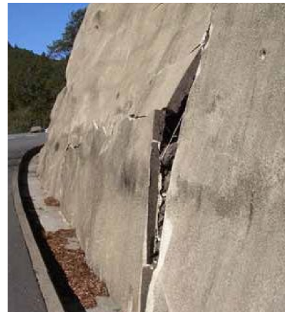
目地のずれ，はらみ出し
