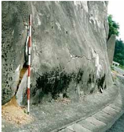
水平ひび割れ，はらみ出し
