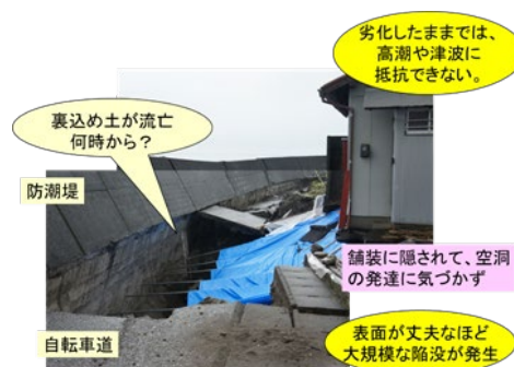
図-1 高潮による防波堤裏込の空洞化被害 2)
