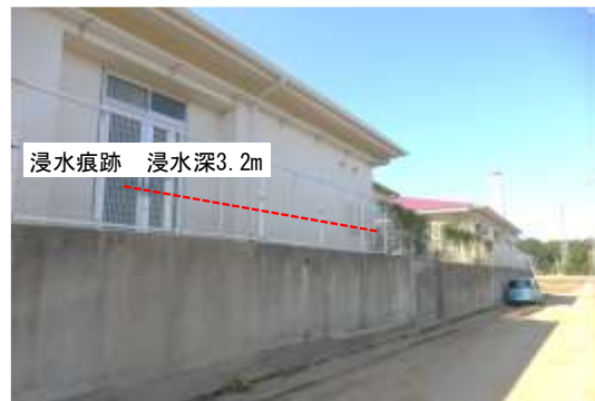
写真-1 A1地点の浸水痕跡
