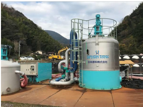
写真-2 吉田仮設施設の大型濾過装置
