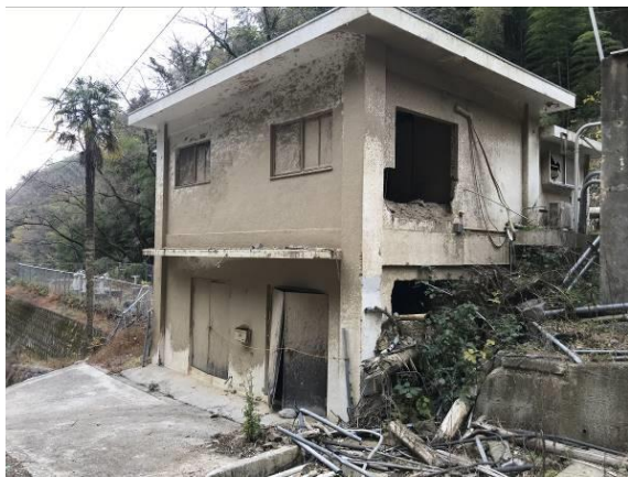
写真-1 被災した吉田浄水場
