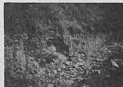
図8 地すべり部分の先端 貞光町家賀西端、緑色片岩の風化による土壌と角礫から成る
