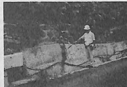
図6 猿飼地すべり地の土止めにできたひび割れ
