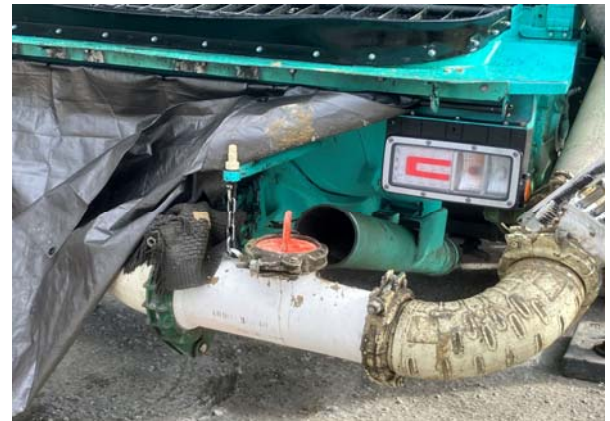
写真-3 T字管
