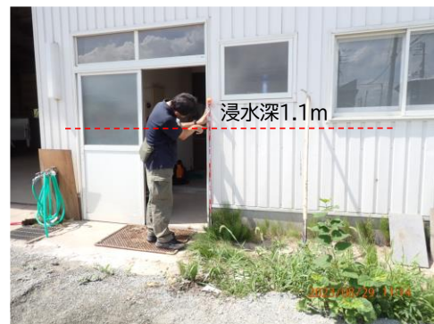
写真-6 E地点・西磯ノ目町の浸水痕跡 （浸水深 1.1m）
