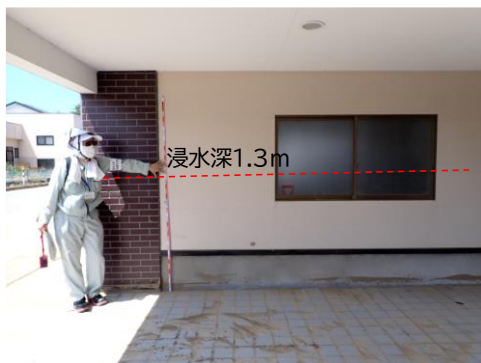
写真-5 D地点・東磯ノ目町の浸水痕跡 （浸水深 1.3m）
