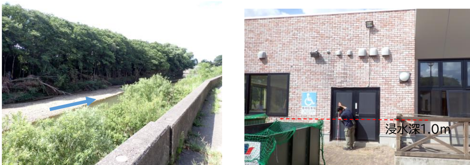
写真-3 高齢者施設①前の馬場目川と施設出入口ドアに残る浸水痕跡（浸水深 1.0m）
