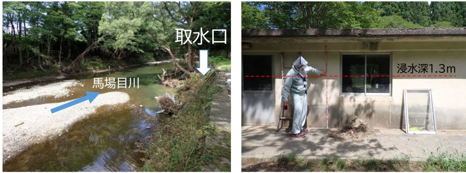
写真-2 五城目浄水場前の馬場目川と取水ポンプ施設の浸水痕跡（浸水深 1.3m）
