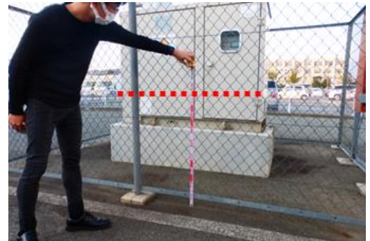
図-7 施設Bの浸水状況（屋外）
